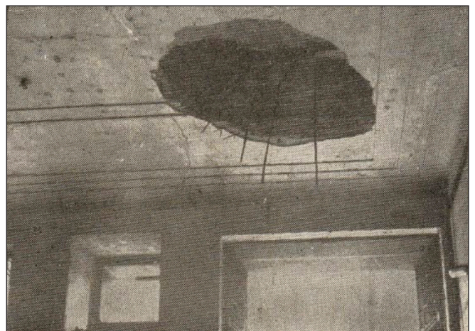
6. ábra: A Mátrai fődém kagylós leszakadása
